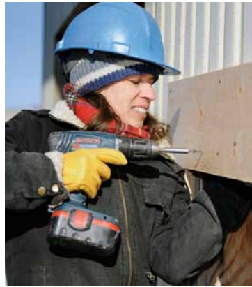
Josée installe le bois de préparation pour la finition qui couvrira les façades extérieures de l'immeuble.
